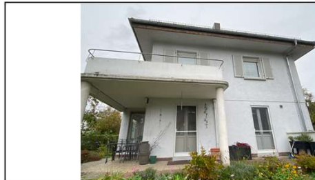
Osten, vom Garten aus konstruktive Wärmebrücke durch großen umlaufenden Balkon -> Sanierung auf
